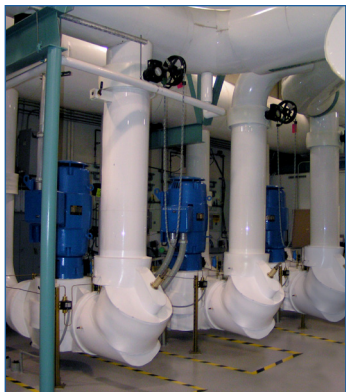
Projeto de Refrigeração do Distrito, Phoenix, E.U.A.
