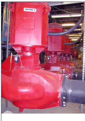
Instalações de Refrigeração do Distrito de Enwave, Toronto, Canadá.
